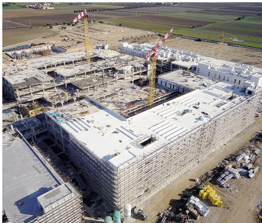
Il cantiere del nuovo ospedale «Covid Ready» di Taranto, progettato dallo studio Ets
