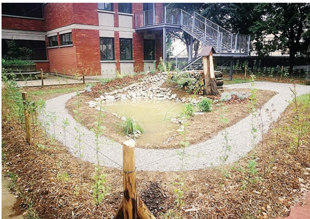
Lavori in corso nell'area esterna della Scuola primaria «Giovanni Pascoli» di Scanzo
