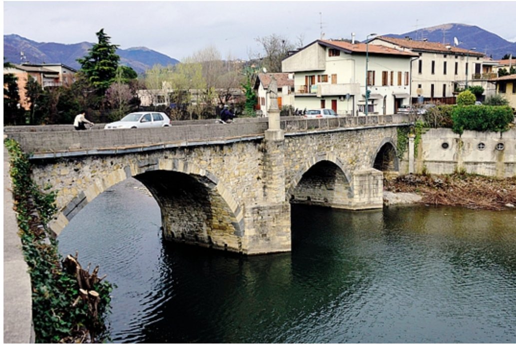
Foto d'archivio del Ponte Marzio che collega Gorle a Scanzo: la struttura necessita di interventi urgenti
